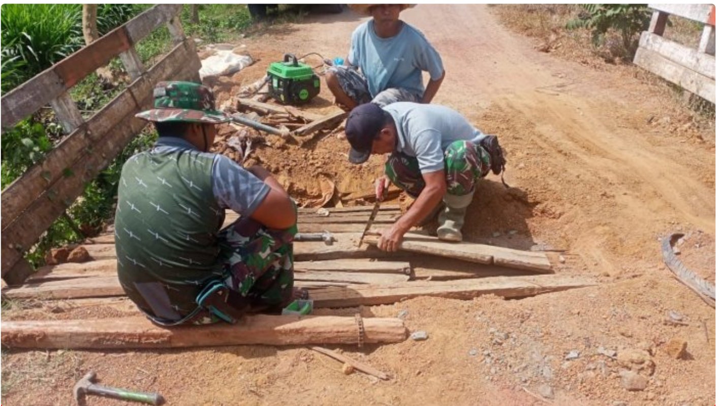
Ada Jalan Berlubang, Dengan Sigap Satgas TMMD Bertindak
